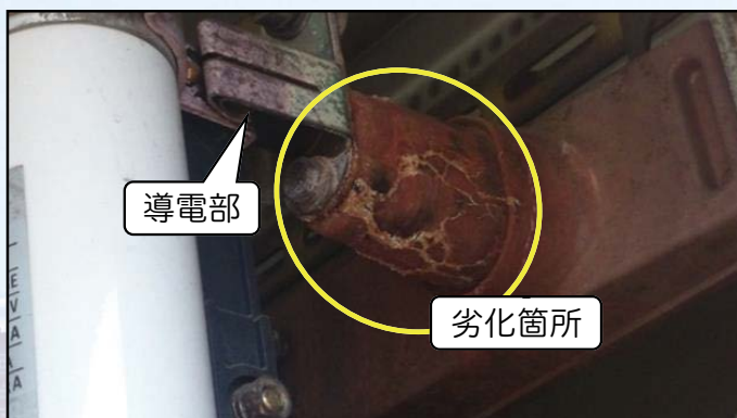
図2 汚損により劣化した高圧受電設備
